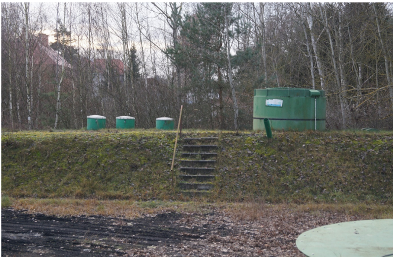
Rys. . Oczyszczalnia ścieków w Modzerowie Źródło: Opracowanie własne
