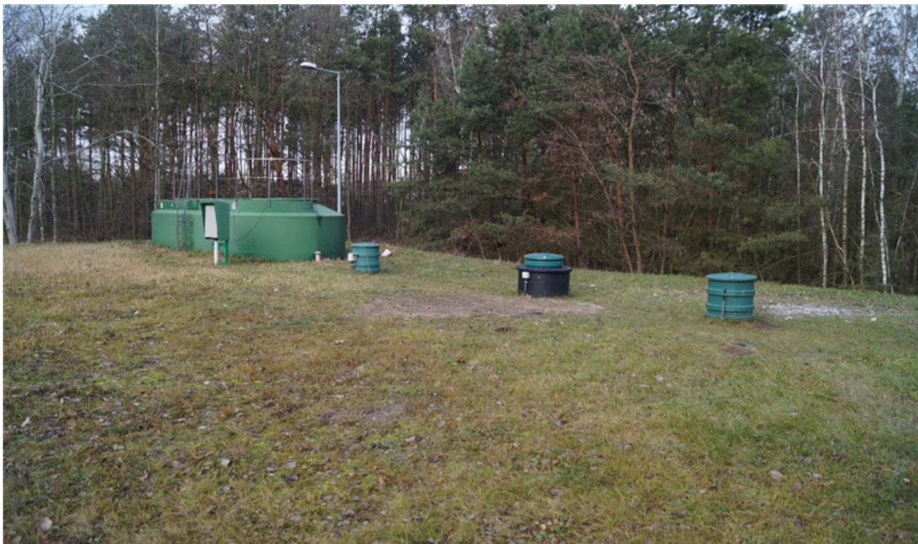
Rys. . Oczyszczalnia ścieków w Modzerowie Źródło: opracowanie własne
